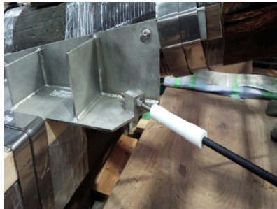
二条城の耐震補強用ブレース
