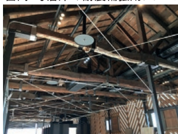
富岡3号倉庫の耐震補強用ブレース
