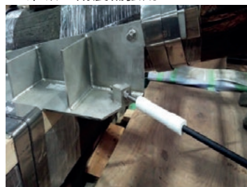
二条城の耐震補強用ブレース
