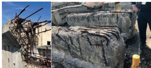
クラックからの水分の侵入や塩害による鉄筋の腐食
