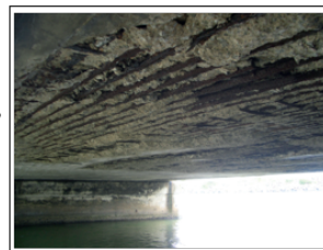
PC鋼材の腐食による損傷事例
